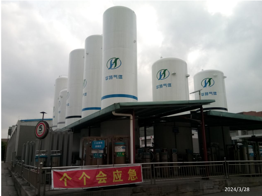
东莞市高能工业气体有限公司现场照片
