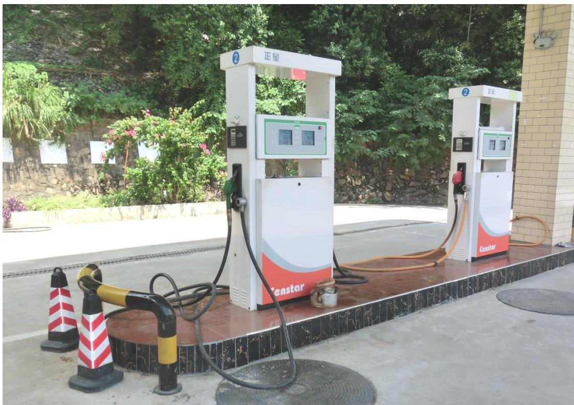
图 2：加油站加油机照片
