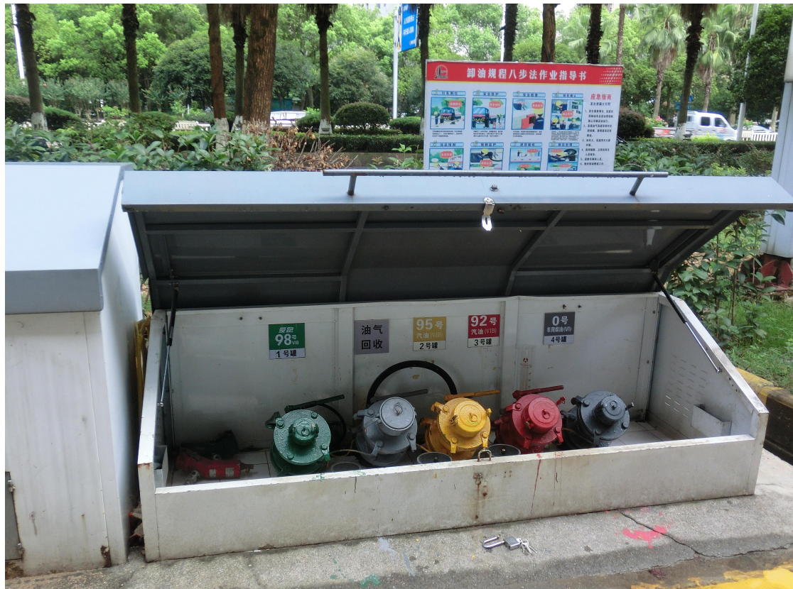
图 4 加油站加油机照片
