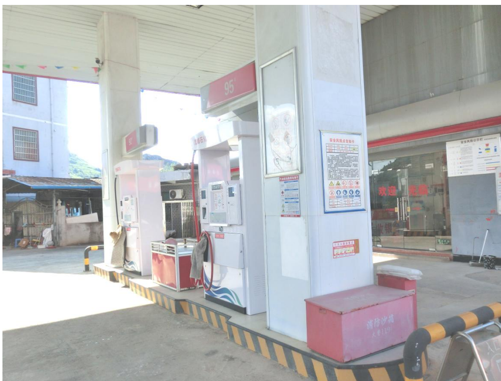
图 2：加油站加油机照片
