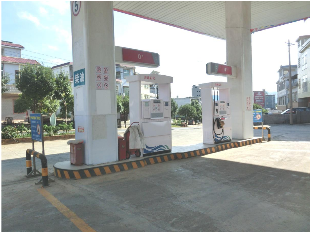
图 3：加油站加油机照片
