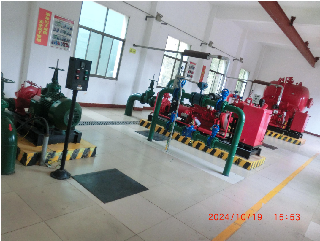
图 4 消防泵房照片
