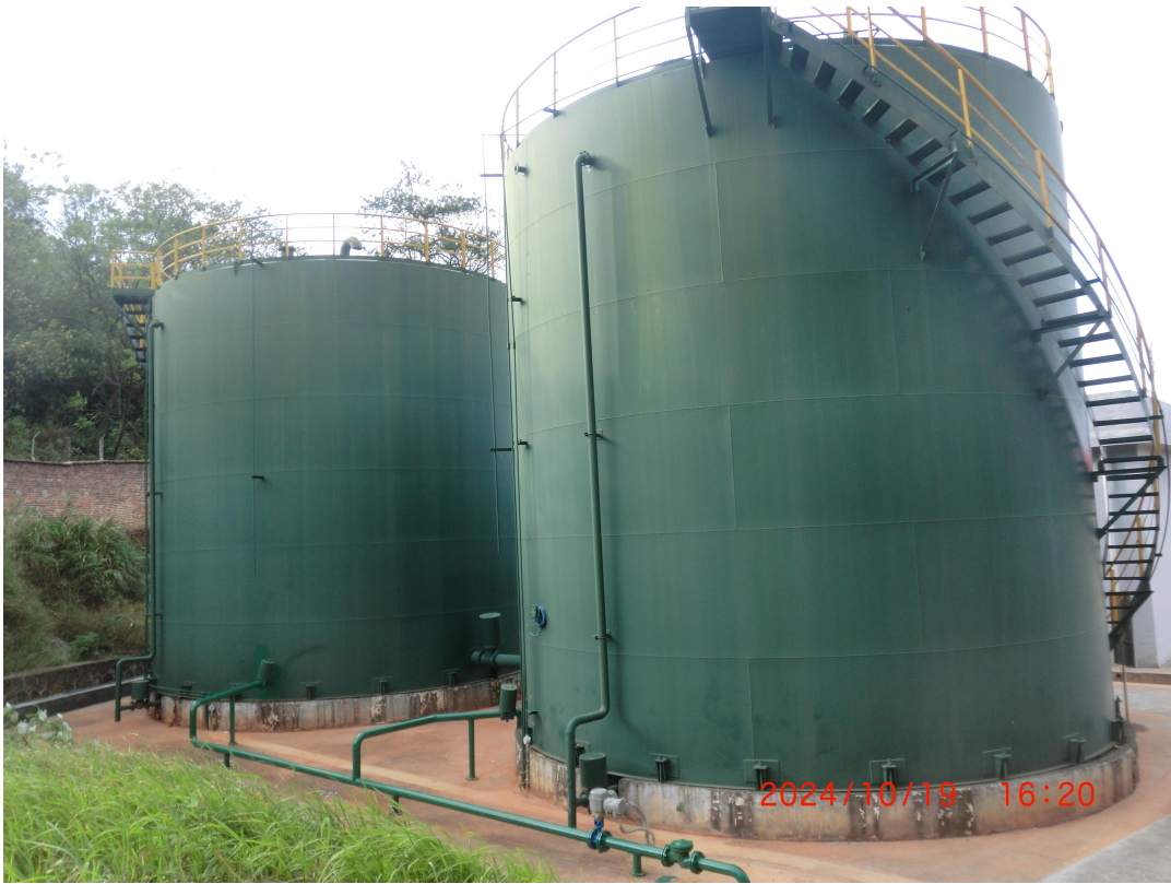
图 3 油库消防水罐照片
