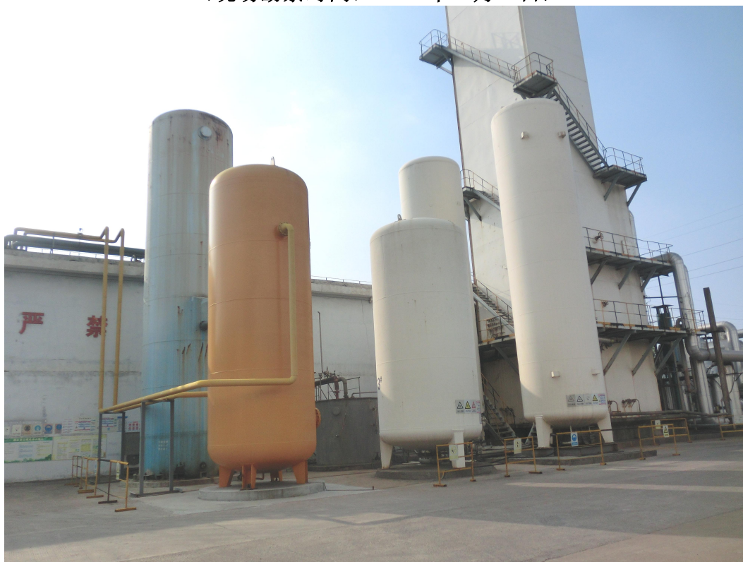
图 1：氧气罐区照片
