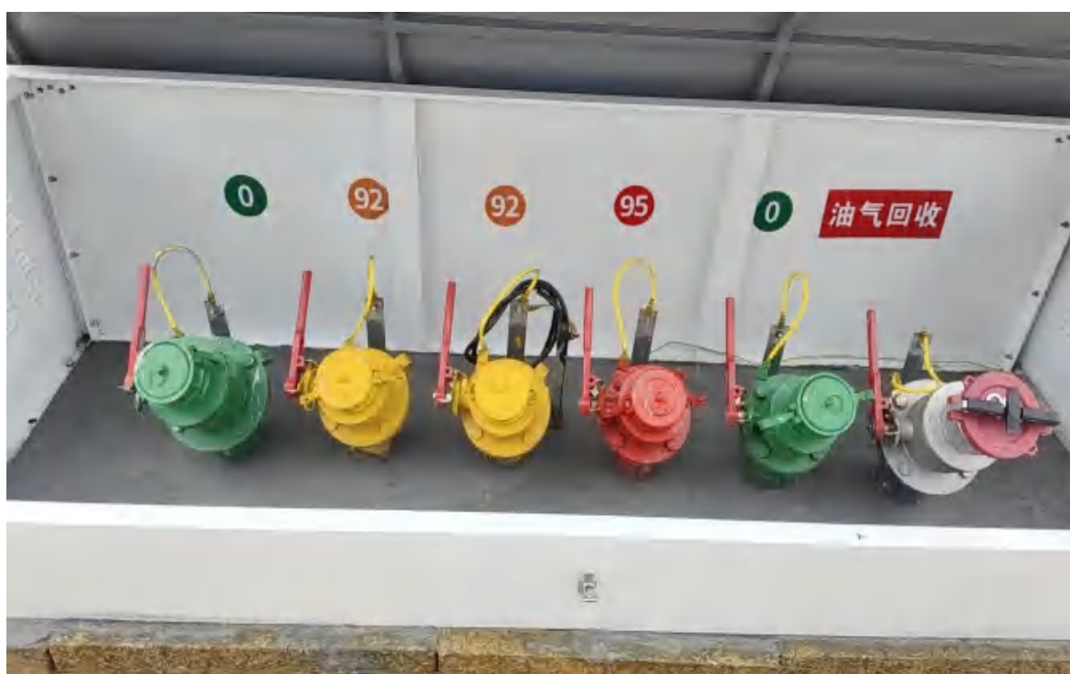
图 2 加油站卸油口照片
