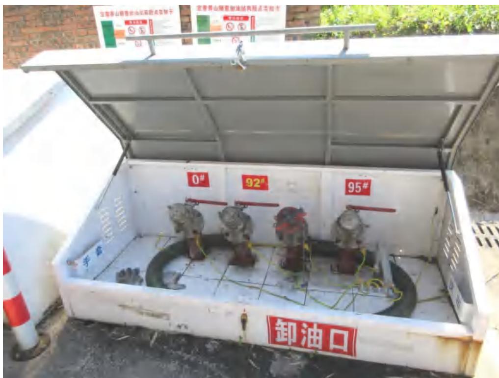
图 3：加油站卸油口照片
