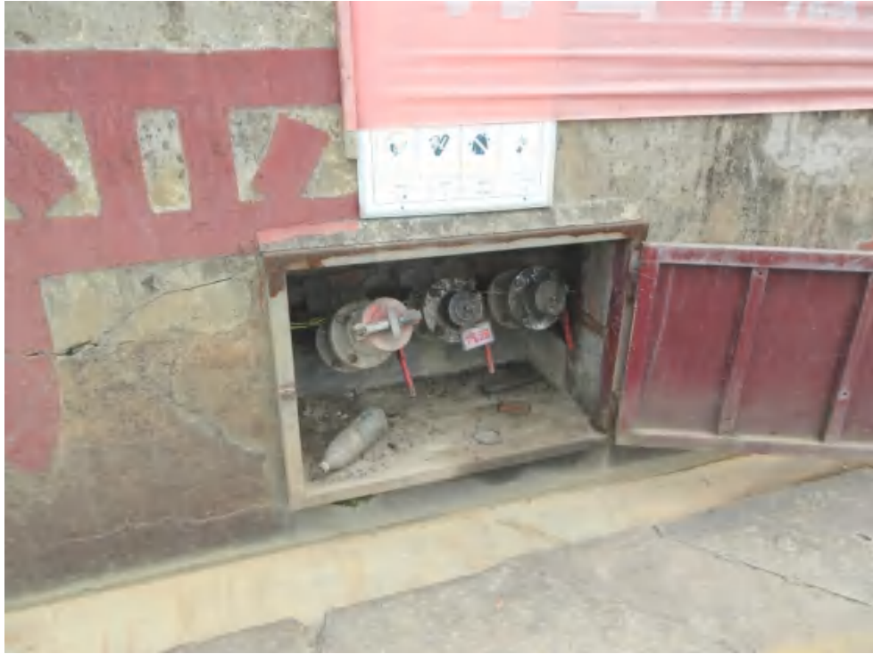
图 3：加油站卸油口照片
