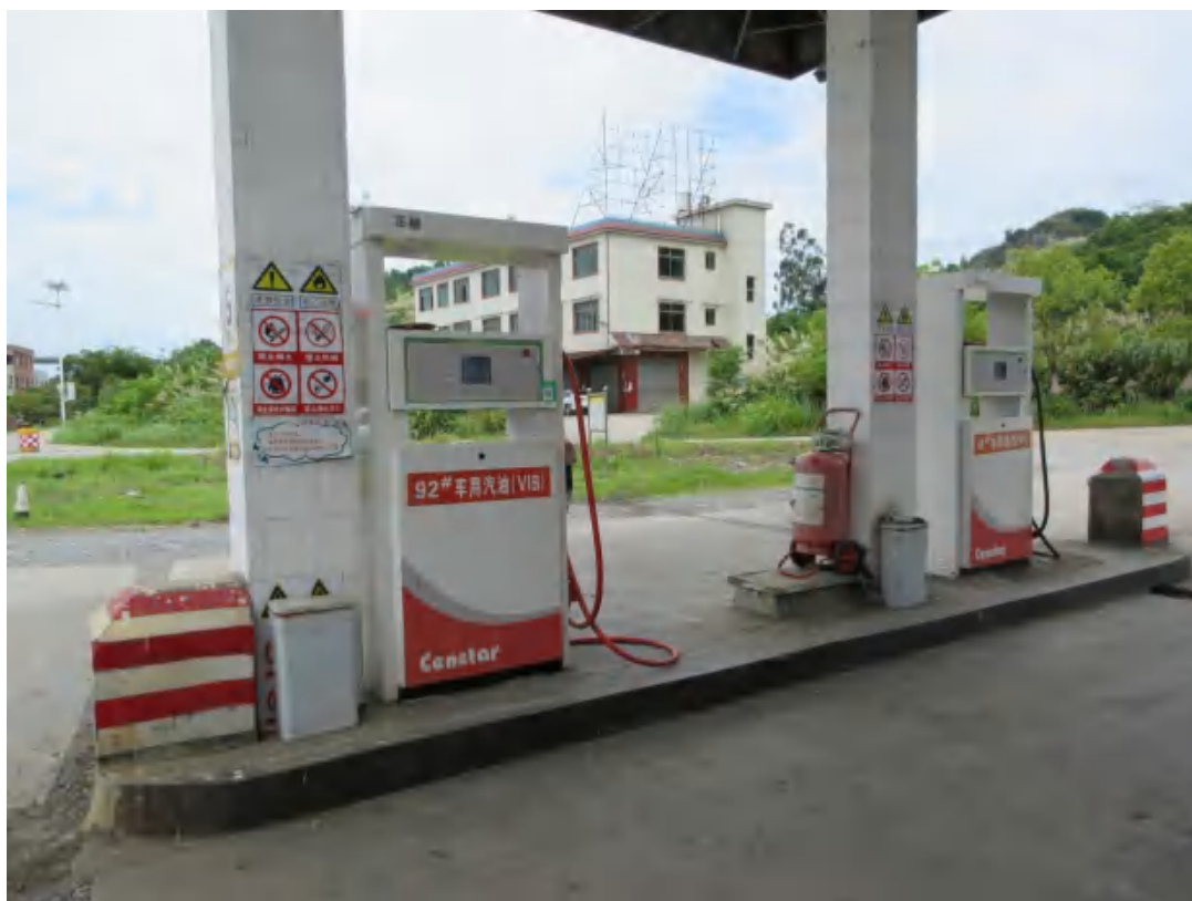
图 2：加油站加油机照片
