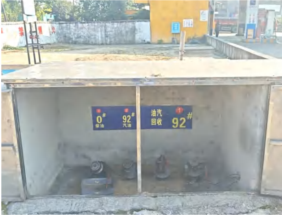
图 5：加油站卸油口照片
