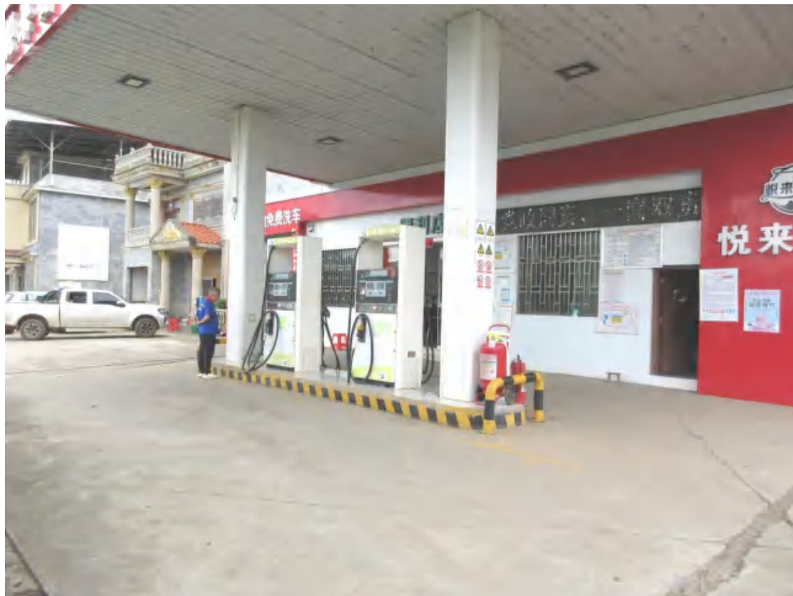
图 2：加油站加油机照片
